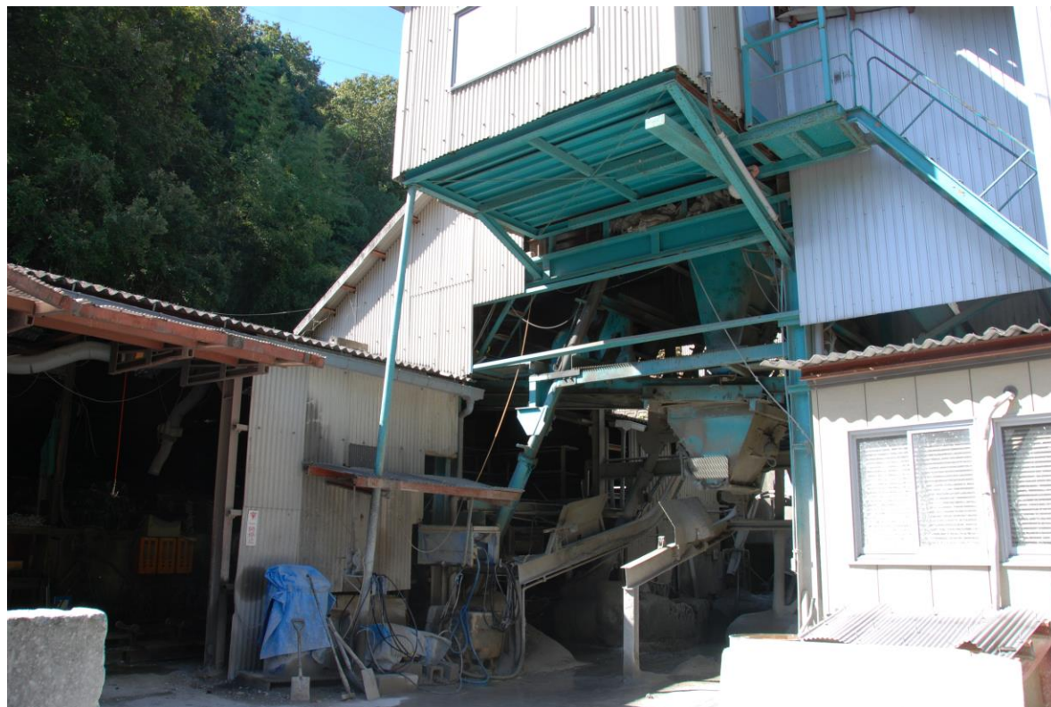
バッチャープラント (服部工場)
