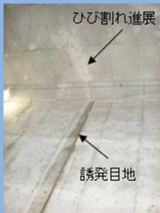
図-3 誘発目地先端からのひび割れ進展
