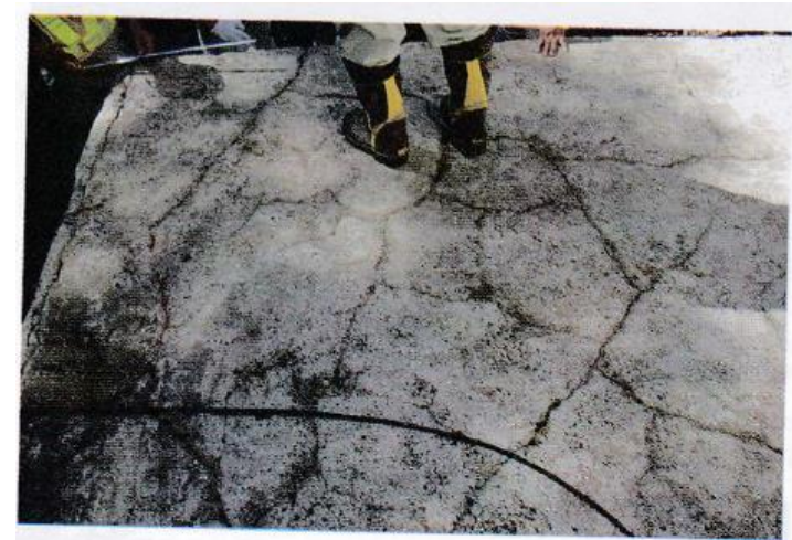
写真-3 フーチングの亀甲状のひび割れ
